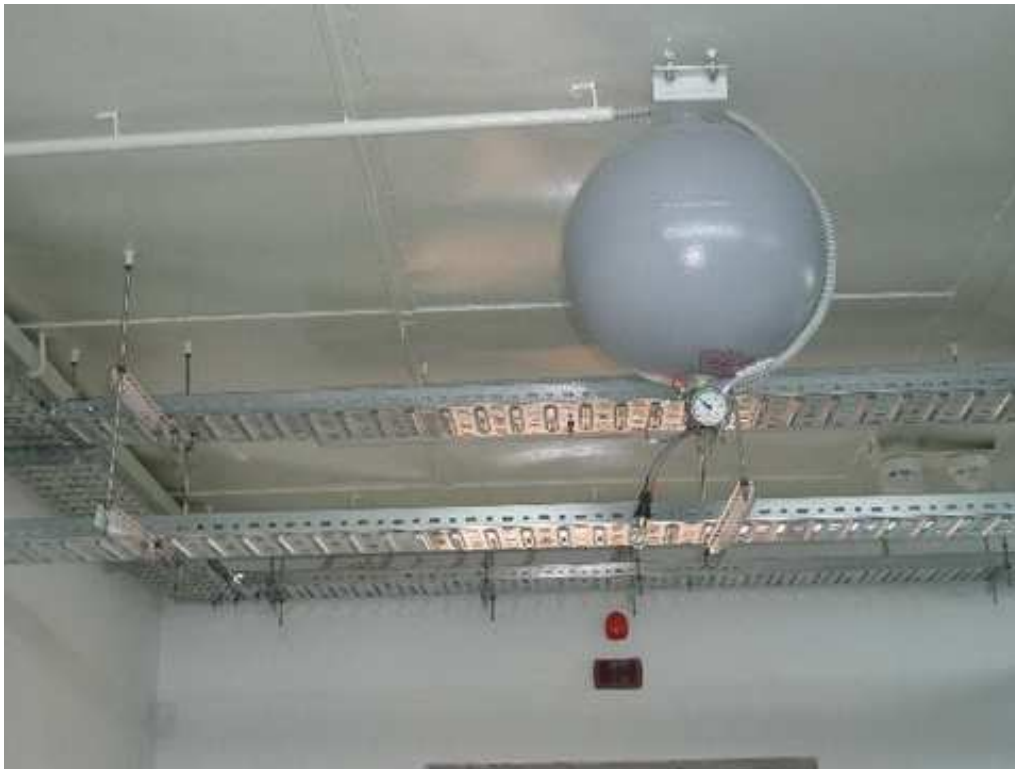
Рисунок 8 - Общий вид установленного модуля газового пожаротушения
