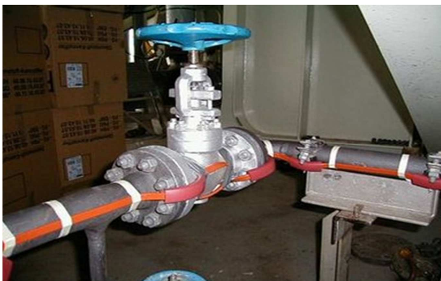
Рисунок 7 – Прокладка греющего кабеля на задвижке
