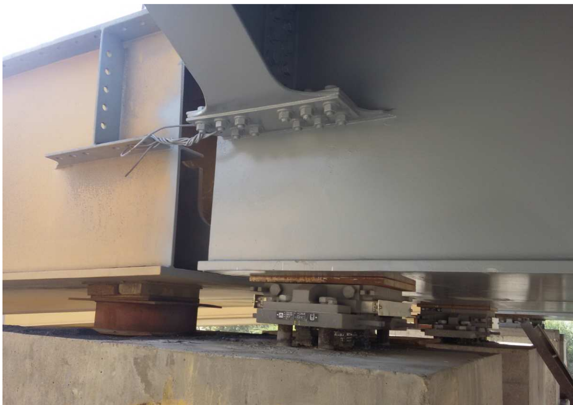
Рисунок 5 - Общий вид смонтированной опорной части без устройства подливки выравнивающего слоя площадки подферменника
