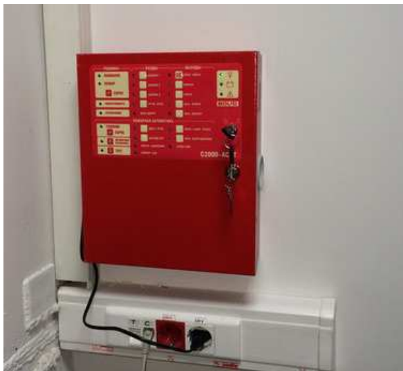
Рисунок 2 - Приемно-контрольный прибор управления автоматической установки порошкового пожаротушения
